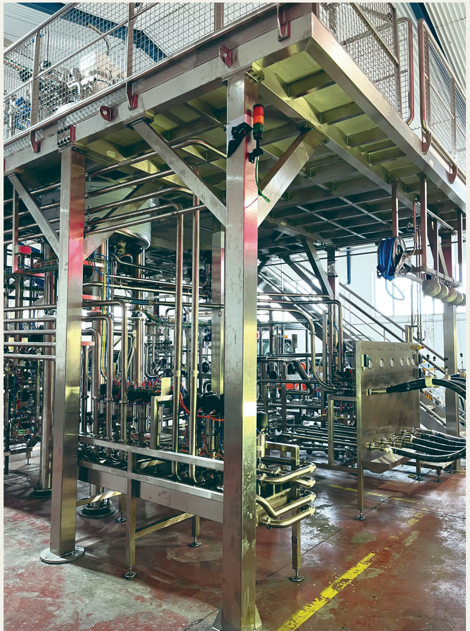
Imagen correspondiente a la fase de montaje en los talleres de Orbita Ingeniería para las pruebas FAT.
